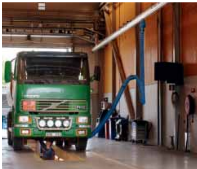
Sistema de extracción de gases escape para IVVs.
